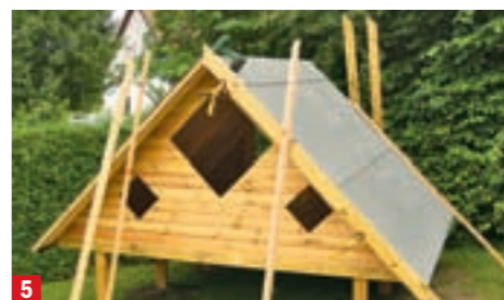
5 Den First mit dem Rest Dachpappe bedecken. Die Abdeckbretter anzwingen und an den ...
